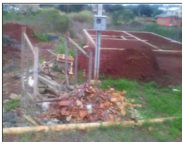
FOTO 05 – Disposição irregular RCC
