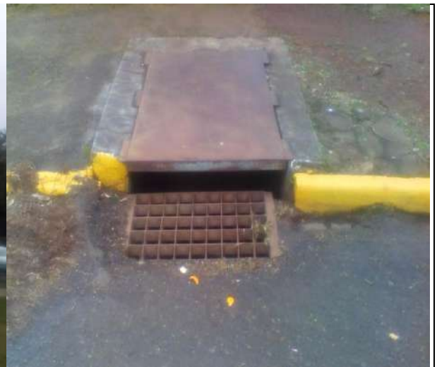
FOTO 04 – Boca de Lobo
